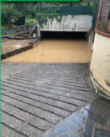
Allagamento di una autorimessa.
